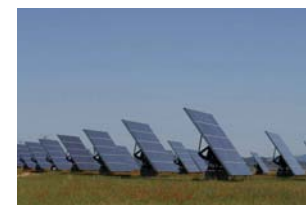
PARQUE SOLAR DE OLITE (Navarra) 350 kW- 30 seguidores
