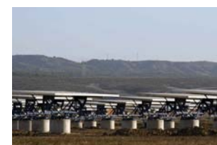
PARQUE SOLAR DE VILLAFRANCA (Navarra) 4,2 MW- 336 seguidores
