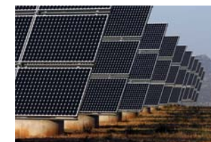
PARQUE SOLAR DE PUERTO LÁPICE (Ciudad Real) 3 MW- 330 seguidores
